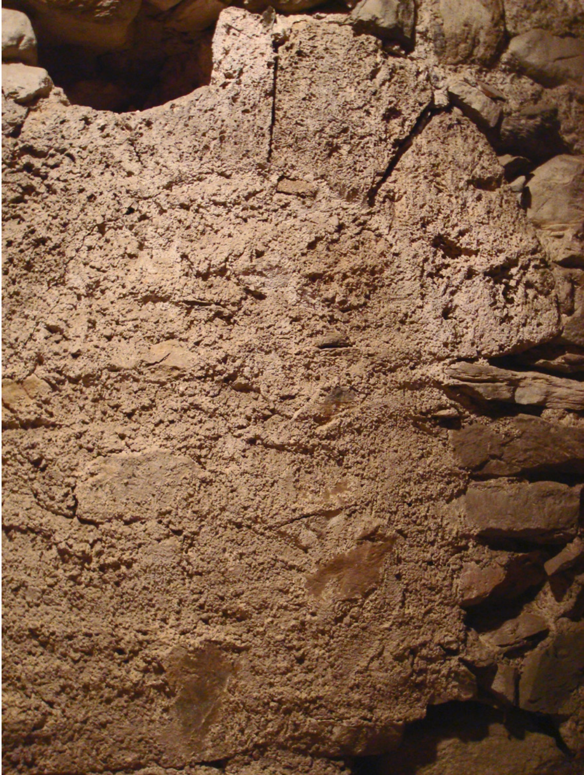
Fig. 5. Baie aux claveaux de tufs visible dans le mur sud de la première travée. Photo S. Bochaton.
